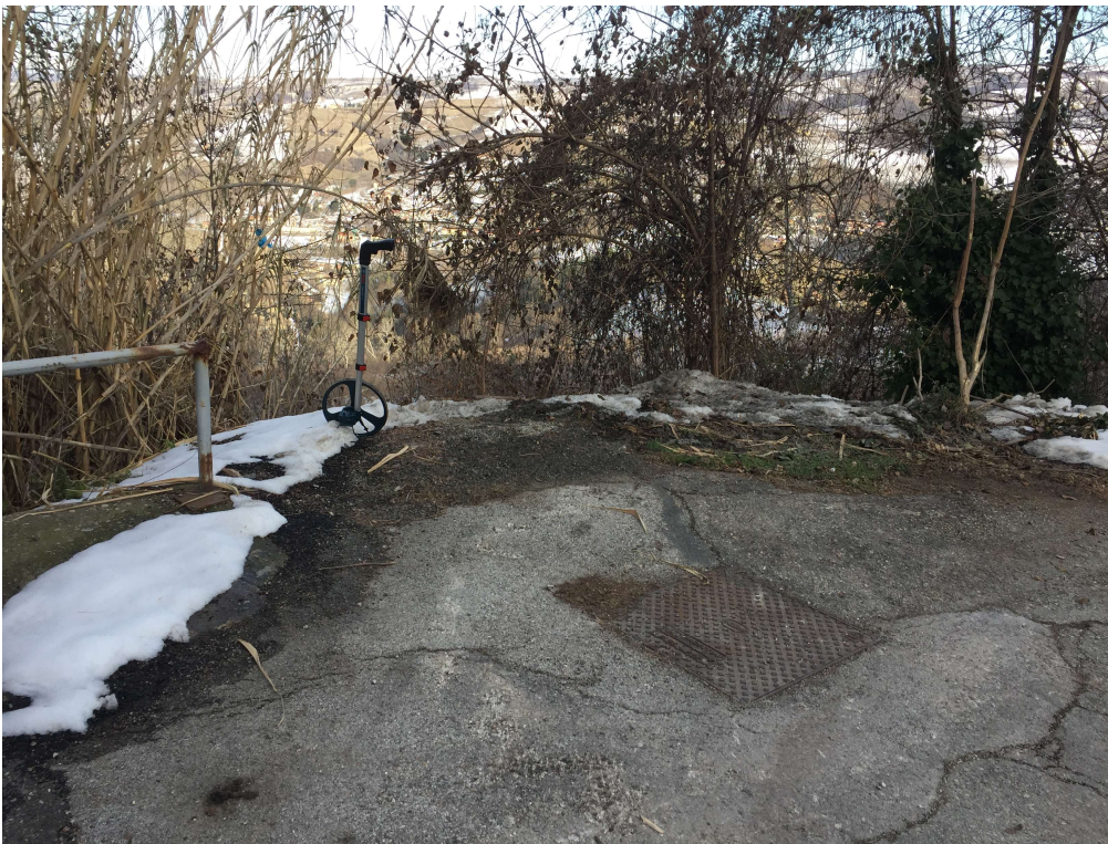
- Fotografia n. 4: Raccordo a monte dell'area di intervento
